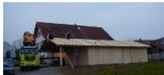
3. Dezember 2002 um 15 Uhr: Durch schweizer Präzisionsarbeit steht das Weinlager bereits zur Verfügung
